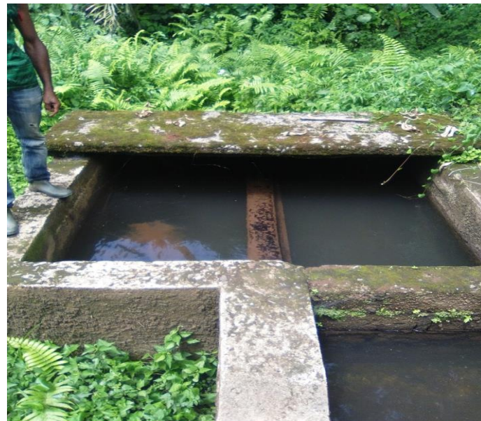
Compartiment à filtre à sable grossier
