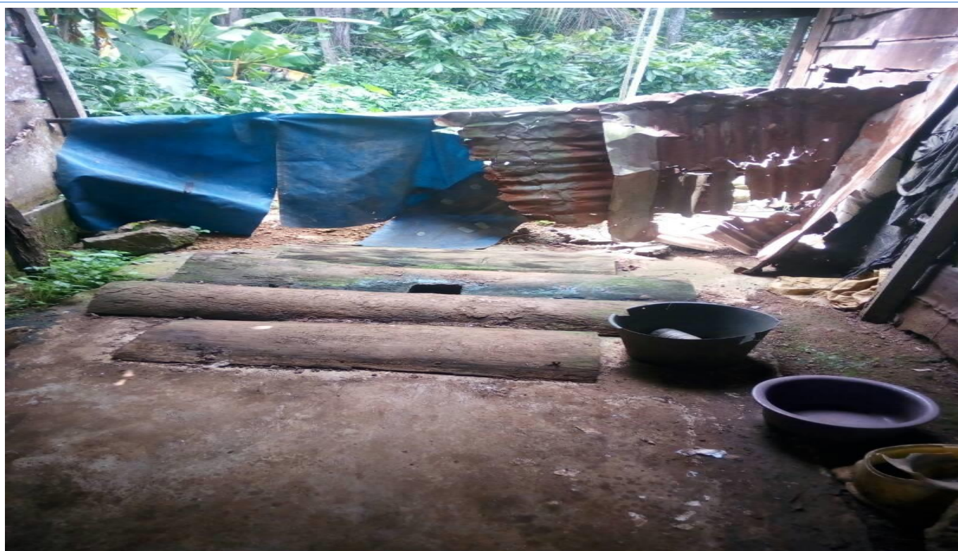
Image 5: Latrine à fond perdu d'un ménage à Manengole
