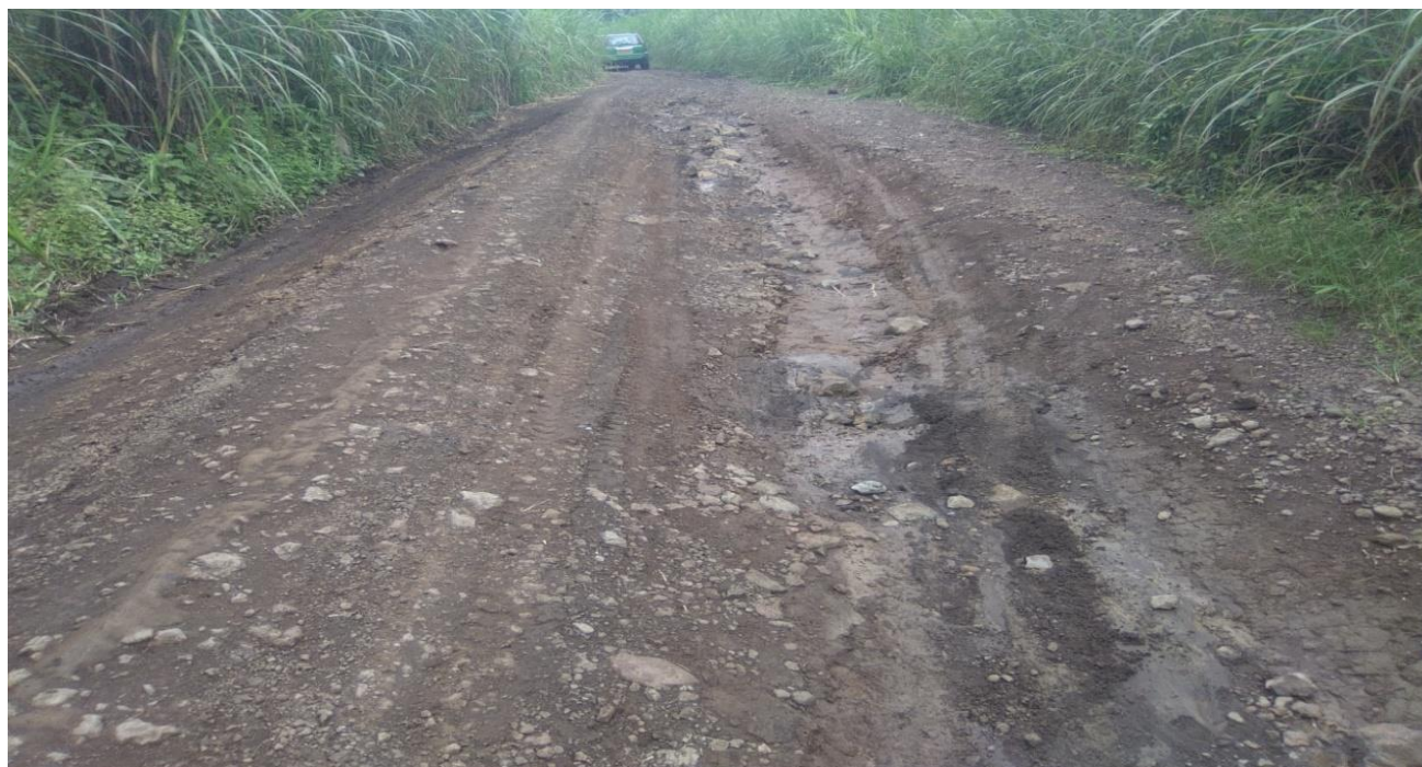
Image 7: Route en terre avec assainissement bilatéral obstrué par les herbes et causant un ravinement important (axe Bakwat/Manengole)
