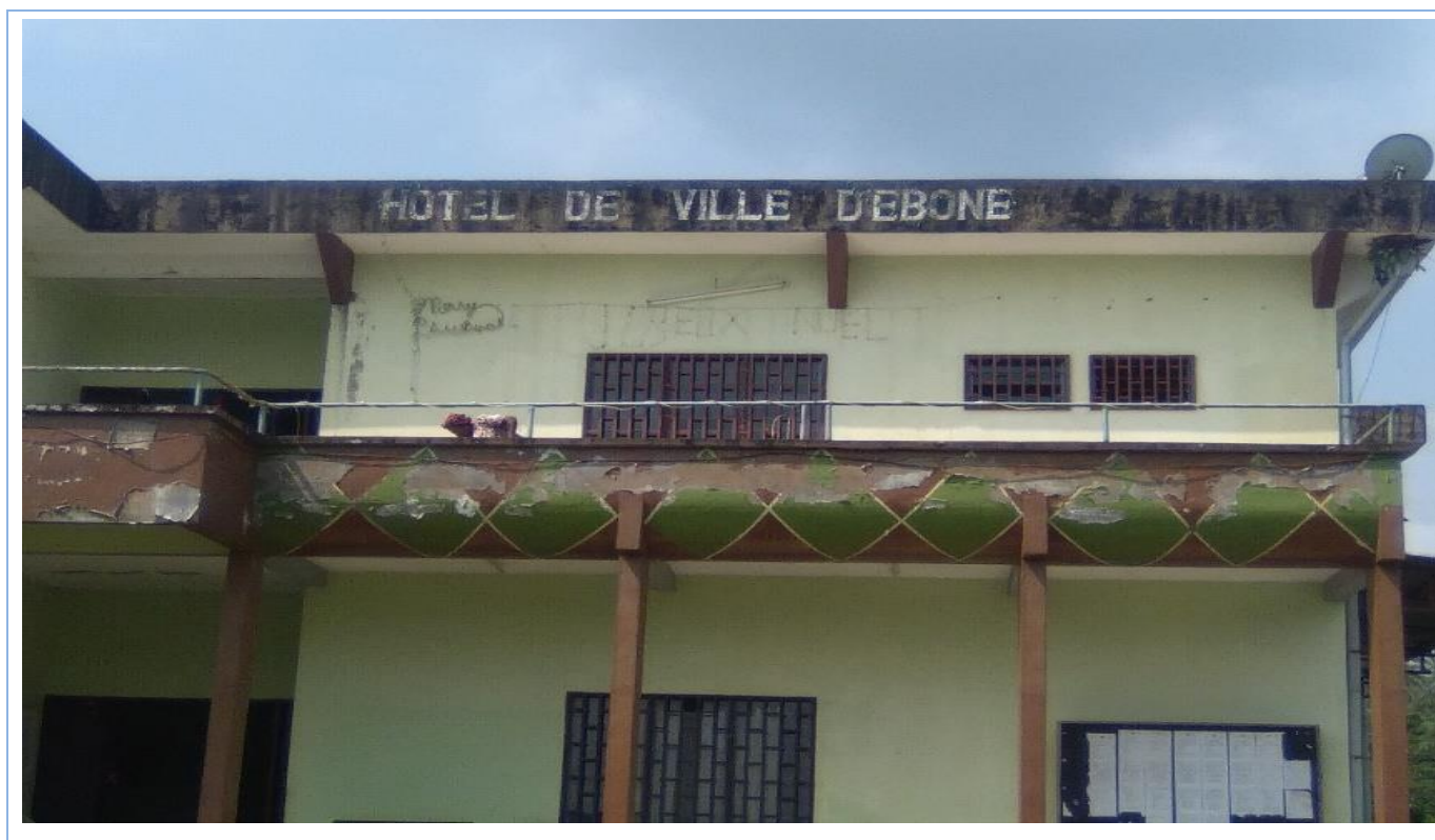
Image 13: Etat des dégradations de la façade de l'hôtel de ville d'Ebone
