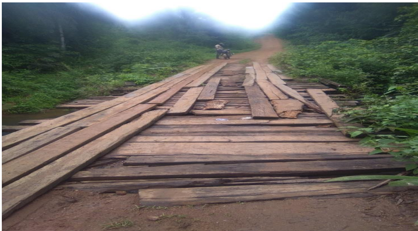
Image 3: Pont en mauvais état sur le chemin de Mangamba
