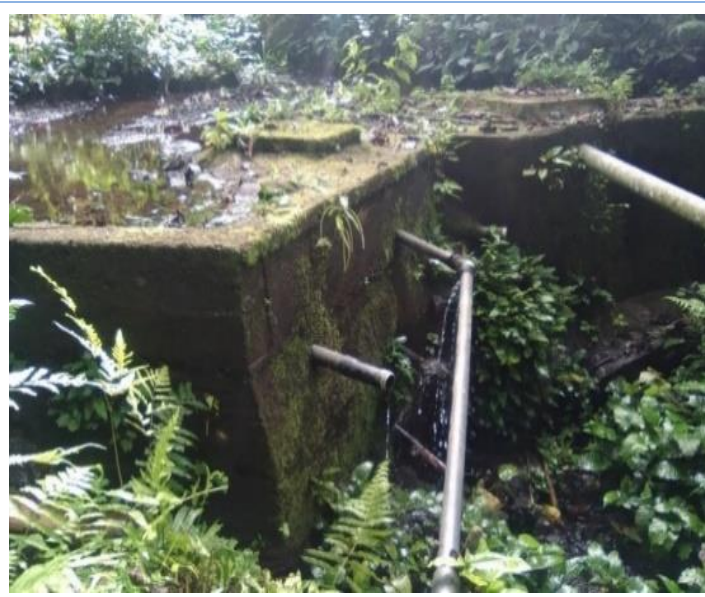
Captage de Salmoa
